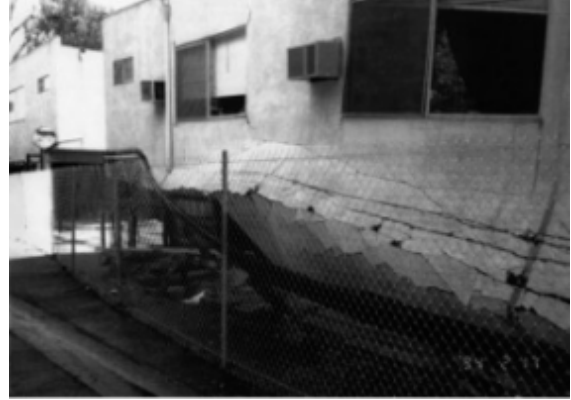
写真15 潰れた駐車場
