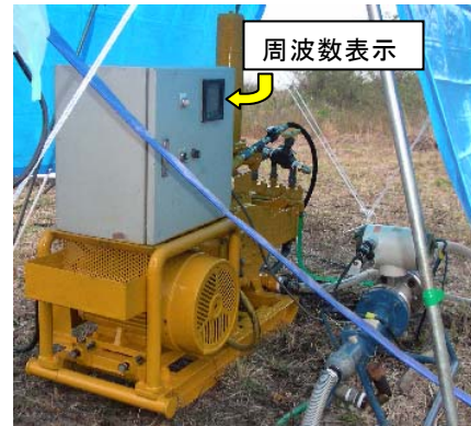
写真4 ポンプとインバーター
