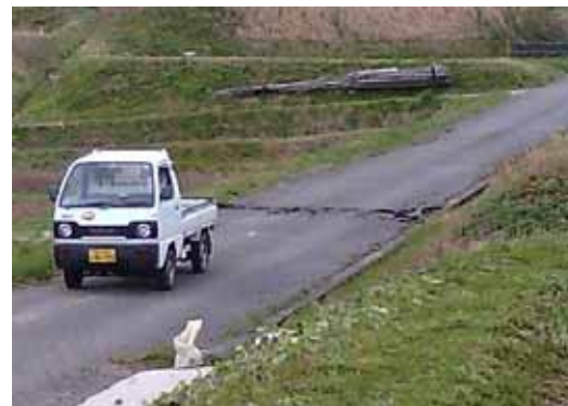
写真5 道路の地割れ
