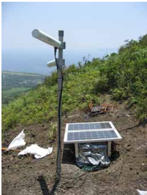
写真1 無線LAN中継点外観
