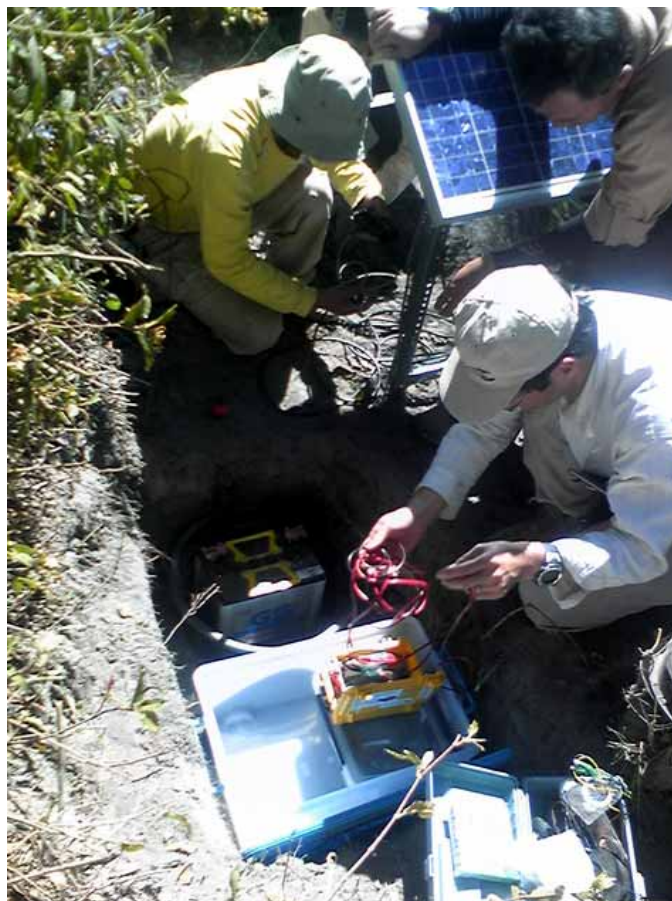
写真5 観測システム設置の様子
