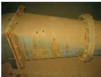
写真1 メンテナンス前の様子
