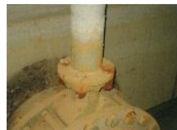
写真3 ボルトの錆状況
