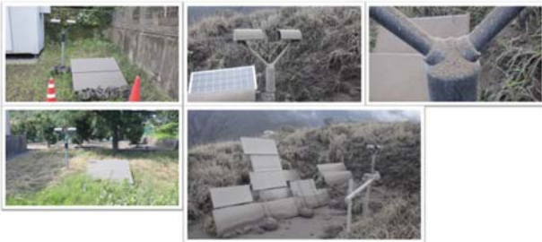
図 6. 降灰後のソーラーパネル状況
