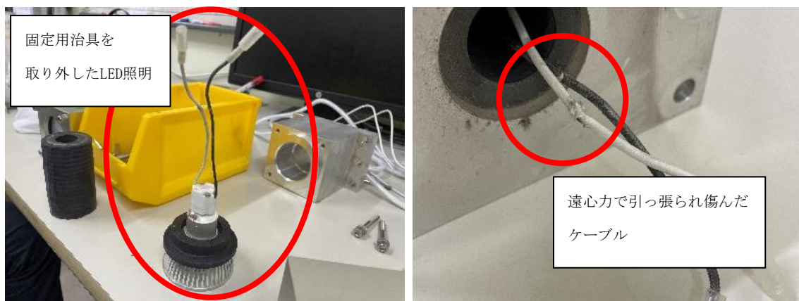
写真3 LED照明ケーブルの様子
