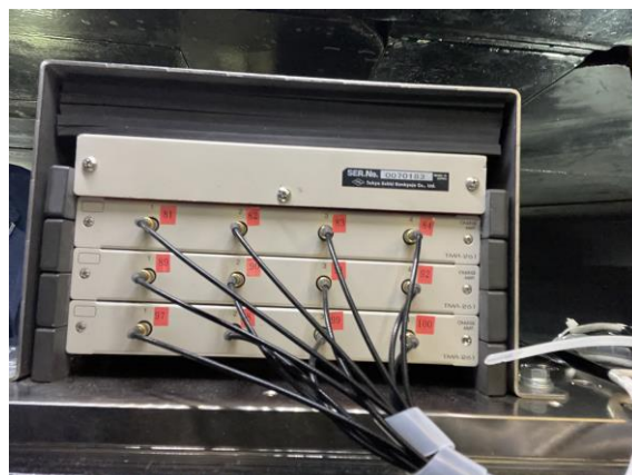
写真8 チャージアンプユニット
